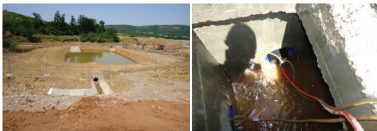
Fig. 259. Laguna për pastrimin e ujërave dhe testimi i kanaleve
