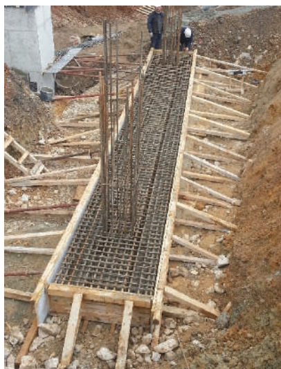
Fig. 130. Ndërtimi i themelit shiritor nga betoni i armuar – armimi i trarit të kundërt.
